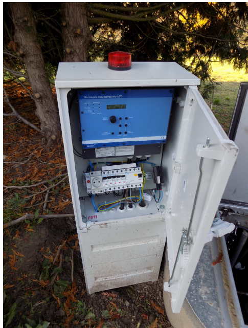
FOTO 7 Widok szafy elektrycznej wewnątrz przepompowni PD11
