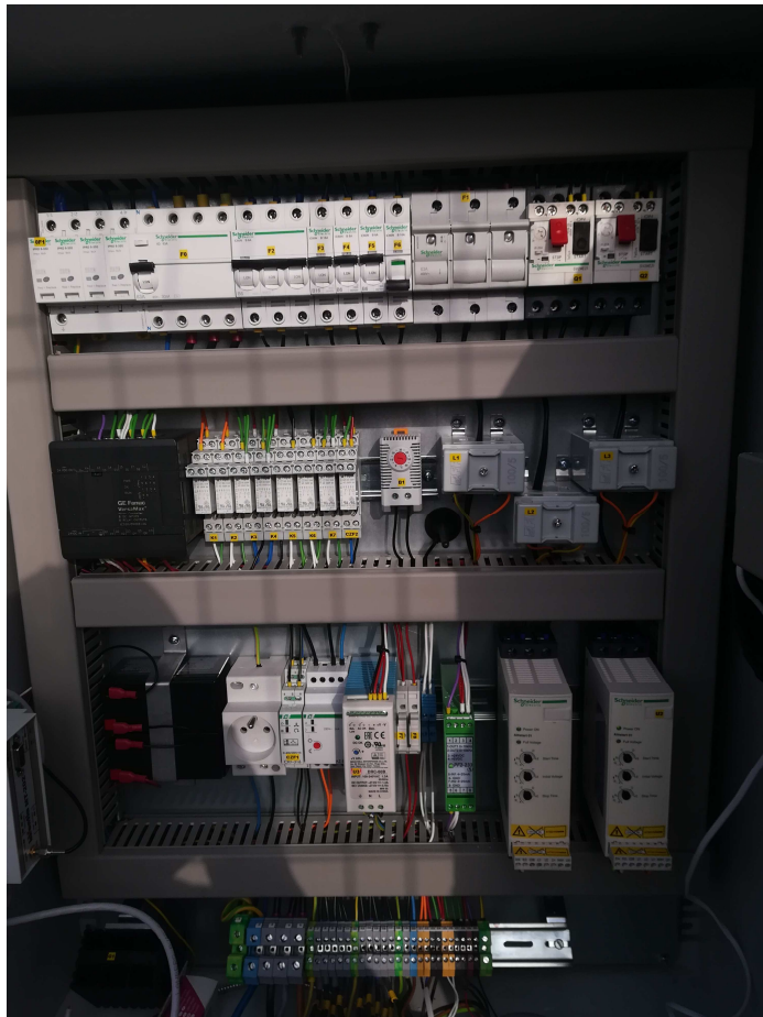
FOTO 4 Widok szafy elektrycznej wewnątrz przepompowni P6
