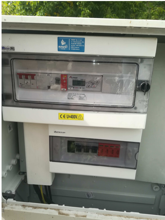
FOTO 11 Widok szafy elektrycznej wewnątrz przepompowni PD12
