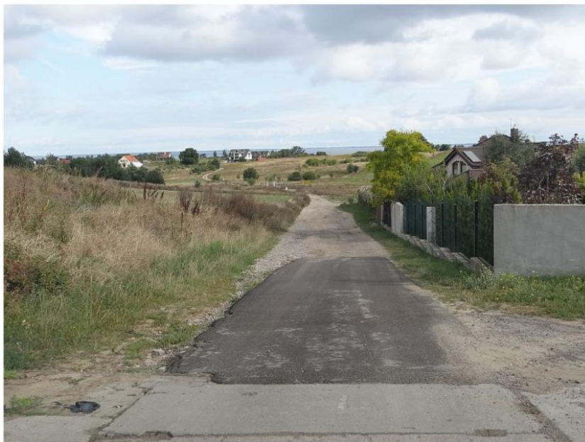
Fotografia 77: Stan nawierzchni na ul. Wiśniowej
