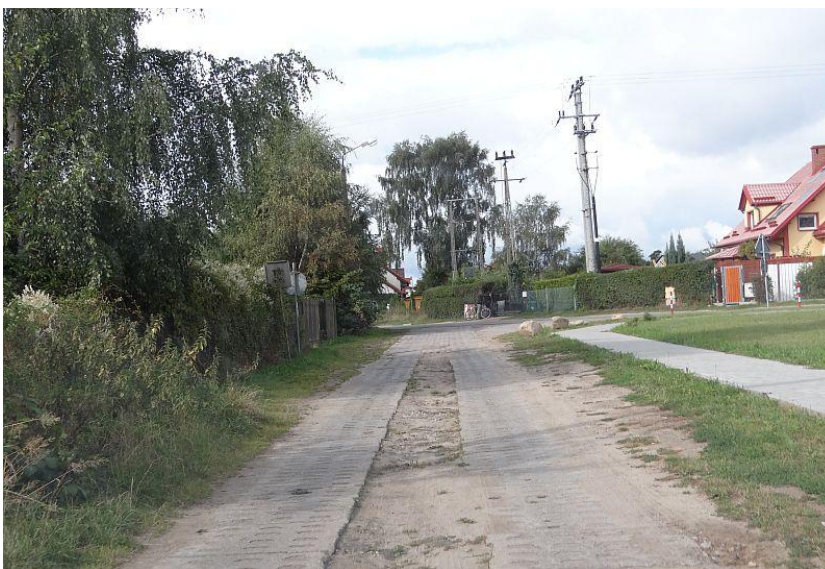
Fotografia 78: Stan nawierzchni na ul. Orzechowej
